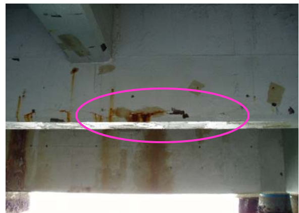
・断面修復部でひび割れ、および、さび汁が認められた、
