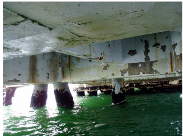
・塗膜剥離およびさび汁が認められた、2006年
