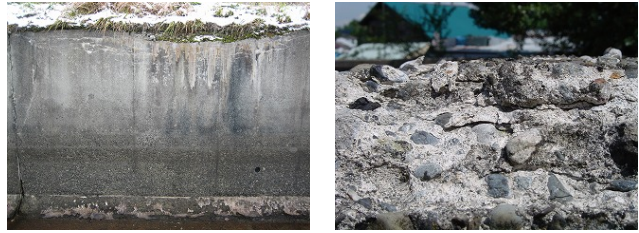
図-1 コンクリート開水路の側壁の凍害および層状ひび割れの発生状況
