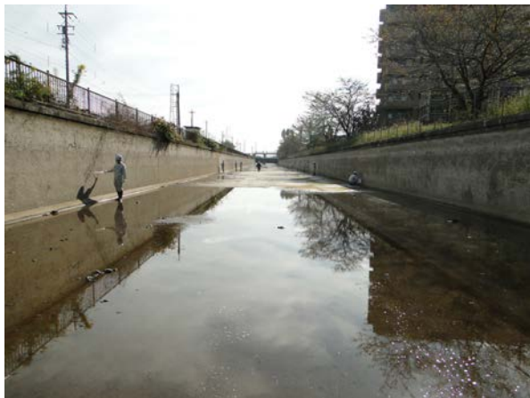
図-1 農業用コンクリート開水路の状況
