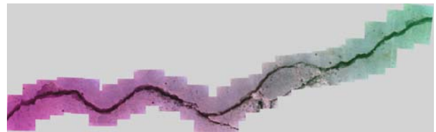
写真-1 ひび割れの一例
