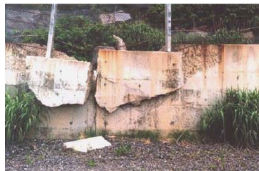
写真 - 1 落石による擁壁の損傷
