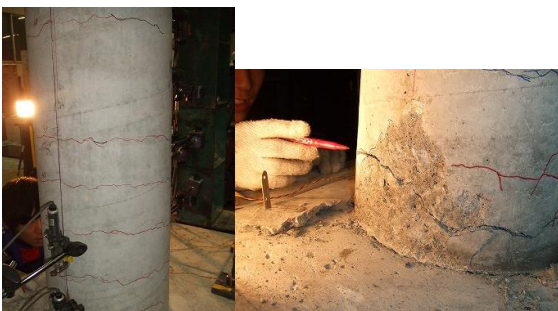
写真-1 杭体損傷状況 (左-Acase, 右-Bcase)
