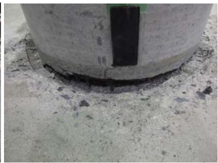
写真-4 基礎部損傷状況(試験終了後)
