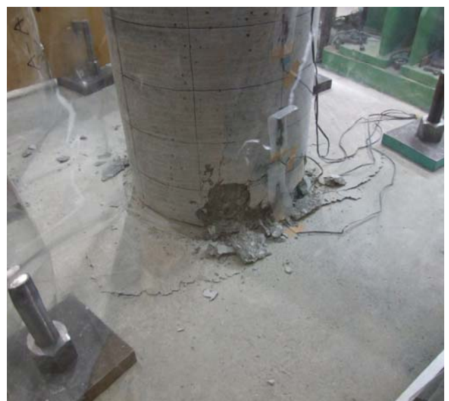
写真-2 試験体 No.1 7 \delta 載荷終了時（試験終了時）
