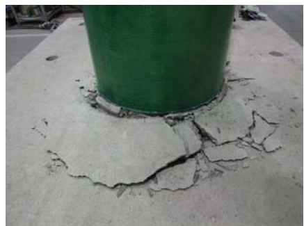
写真-6 基礎部損傷状況(試験終了時)
