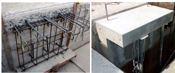
写真-2 コンクリート打ち継ぎ部
