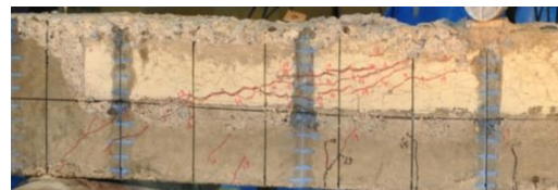
写真-3 最大荷重時の損傷状況 (供試体 C10)
