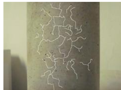
写真-2 500℃加熱後のひび割れ状況
