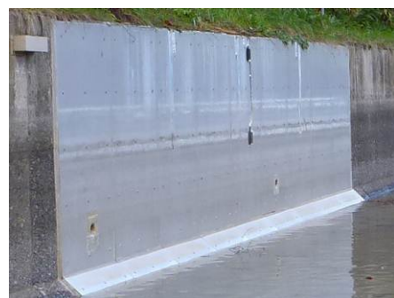
写真-5 FRPM板の施工6年後の状況(南面)
