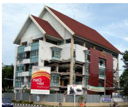
写真-1 インドネシア・スマトラ島沖地震で損傷したRC建物
