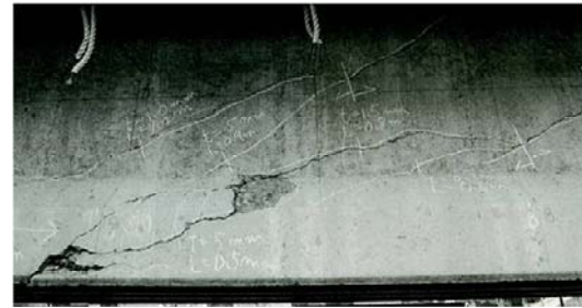
写真-4 主桁側面のひび割れ
