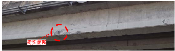
写真-2 主桁に生じた損傷の状況
