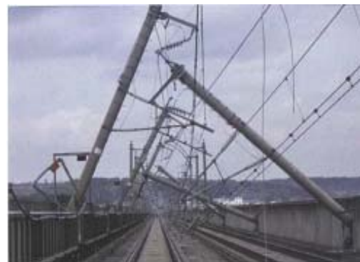
写真 - 1 電車線柱の損傷（東北新幹線） 1)
