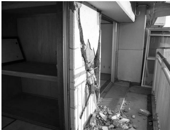
図-4 損傷した非構造壁
