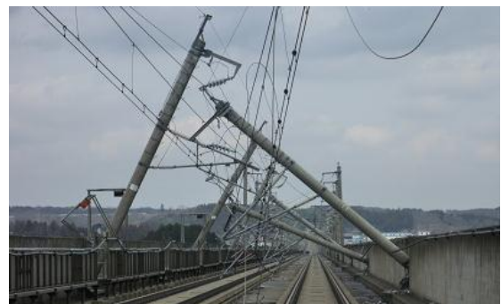
写真-1 折損・傾斜したPC電化柱
