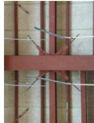
写真—3 屋根ブレースの破断
