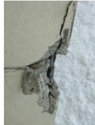
写真—2 SRC柱脚部の損傷
