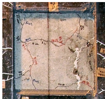
写真-3 母床版の損傷状況
