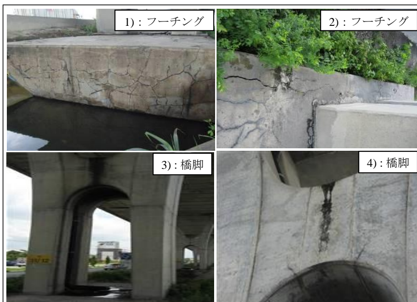
写真-1 構造物の劣化状況
