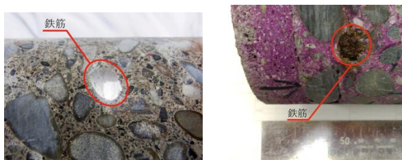
(66号棟 グレード1, 鉄筋断面には薄茶色の錆が少し見られる程度であり、周囲はほとんど錆びていない) (68号棟グレード4, 鉄筋断面は黒色の錆が見られ断面に傷が見られる。周囲にも錆が見られる。)
