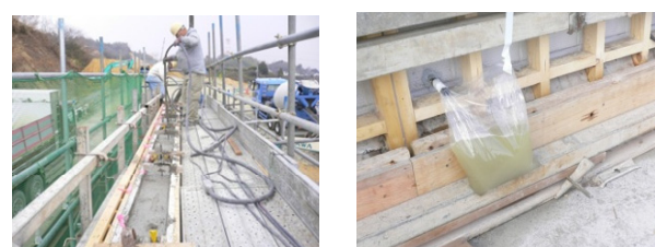
a. コンクリート施工状況 b. 余剰水の排出 写真-5 コンクリートの打込みと初期排水状況
