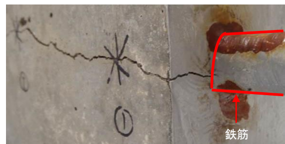
図-12 ひび割れ拡大写真
