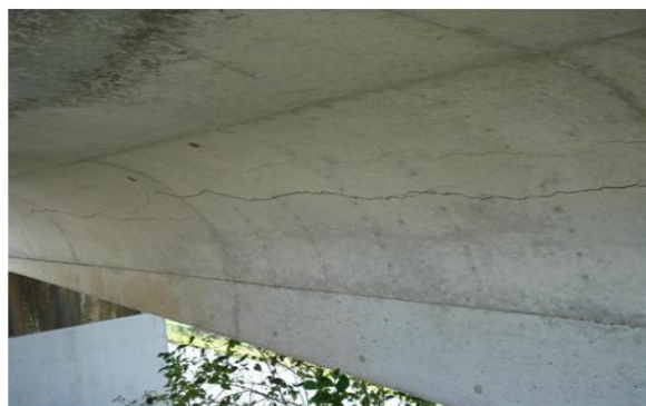
写真-1 ASRによる軸方向ひび割れの劣化事例
