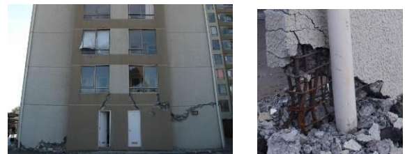
(a)S棟 南面 (b)壁端部コンクリートの圧壊 図-4 S棟南面壁の損傷[1]
