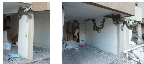
図-5 壁柱[5] 図-6 壁の損傷[11]
