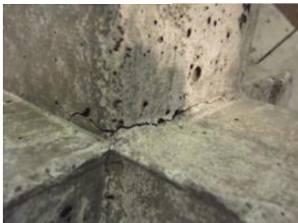
写真-10 NC有筋の破壊性状
