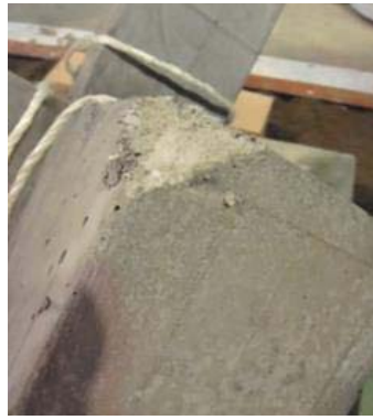
写真-11 HPFRCC+EPSの角つぶれ
