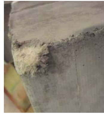
写真-13 HPFRCCの角つぶれ
