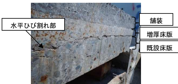
図-9 試験体の水平ひび割れ部の状況
