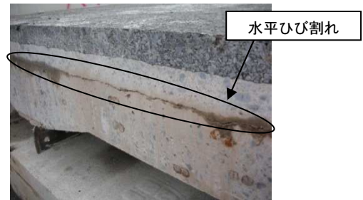
図-1 新旧床版に水平ひび割れが発生した事例
