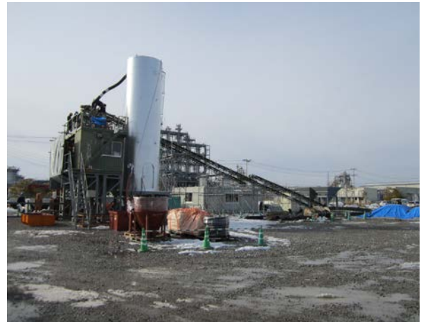
写真-5 専用現地プラント
