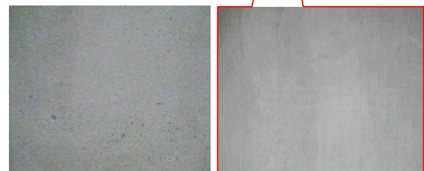
(透水性シートなし) (透水性シートあり) 写真-8 側壁部のコンクリート仕上がり状況
