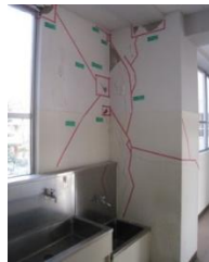
(b) 柱の被害
