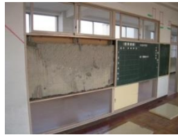
(d) 仕上げ材の剥落
