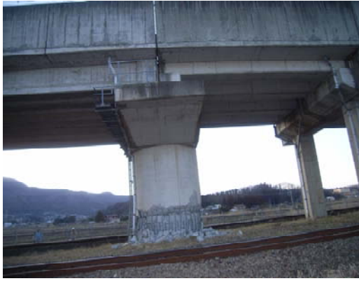
図-7 橋脚 No. 9 の損傷状況
