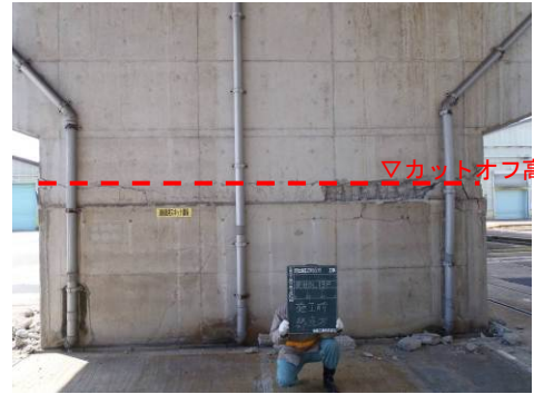
図-2 段落し部の損傷状況①(橋脚 No. 3)
