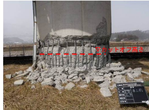
図-3 段落し部の損傷状況②(橋脚 No. 9)
