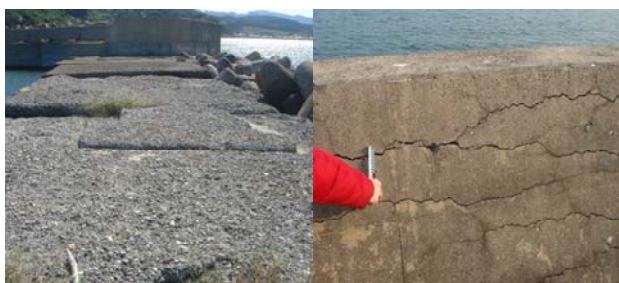
図-2 漁港施設における老朽化の状況
