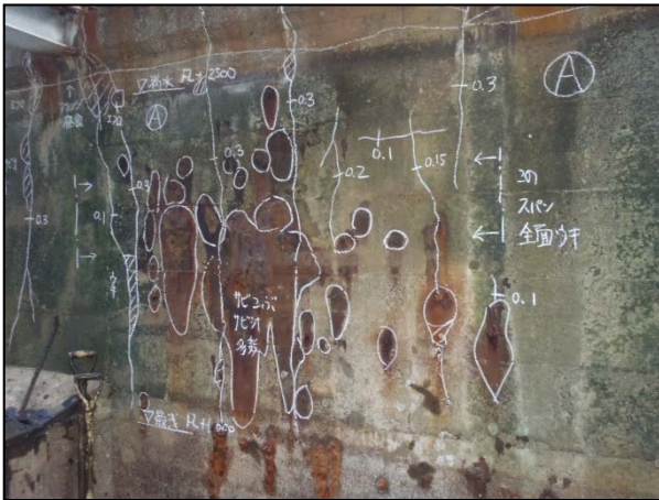
写真-3 劣化部分の状況 (写真-2 と同一位置)
