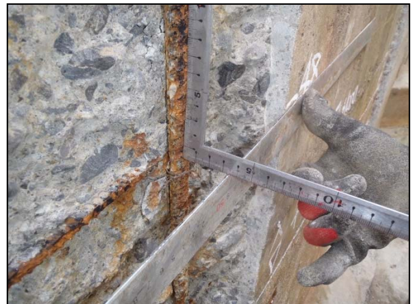
写真-6 劣化部の鉄筋腐食状況
