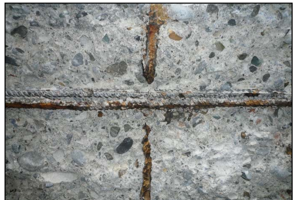
写真-5 劣化部の鉄筋腐食状況 (重ね継手部分)
