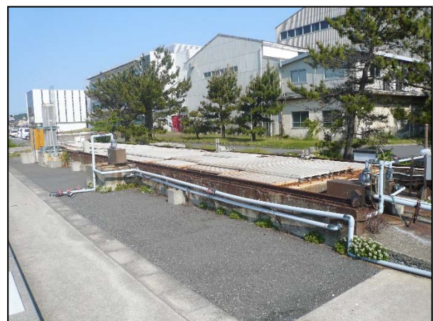
写真-1 海水循環水槽(RC 水槽)の外観
