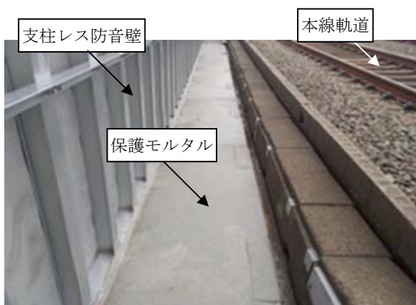
(a) 高韌性繊維補強ポリマーモルタル (ひび割れなし)
