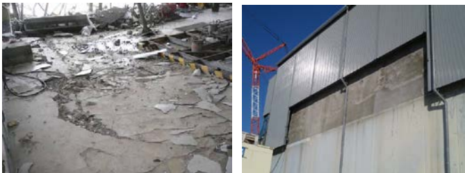
写真-2.1 4号機の損傷と補修後（提供：東京電力）
