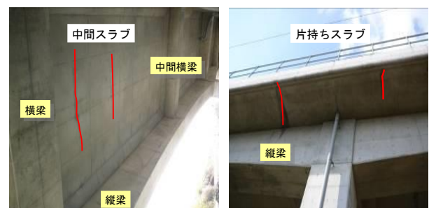
図-1 高架橋スラブのひび割れ例
