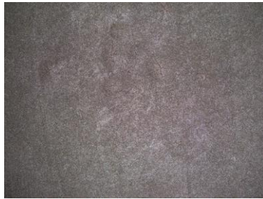
(b) C 浄水場(防水塗装有)
