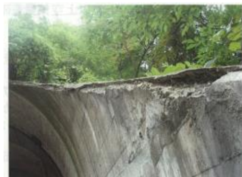
図-1 区界トンネルの坑口の現状
