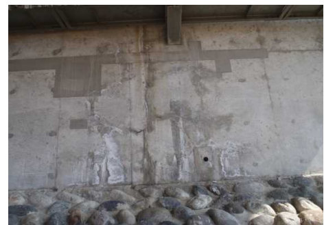
写真-4 ひび割れの発生状況 (構造物 O, 2012 年 12 月の現状)
