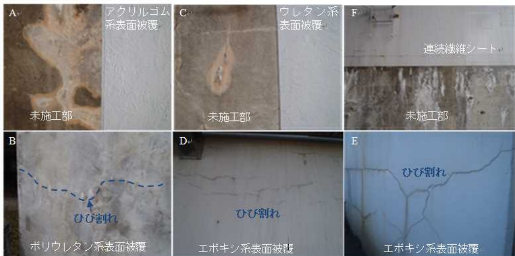
写真-1 表面被覆材の損傷状況の比較 (A~F: 構造物名, 2012年12月の現状)
