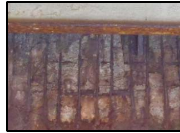
(3)かぶりコンクリートの剥落
