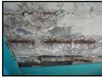
(2)塩害によるはく離
