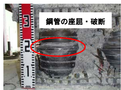
写真-2 鋼管の破断状況 (実験終了後)
