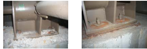
写真-1 1通り支承部の損傷（左：C通,右：M通） 1)
