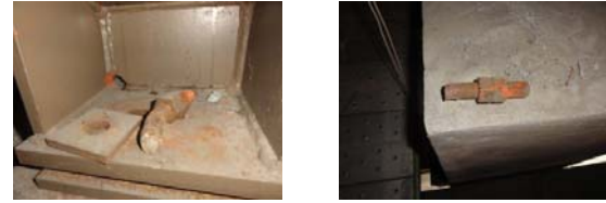
写真-2 アンカーボルトの破断（左：曲げ,右：せん断）
