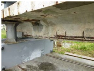
写真-5 W-7 桁の劣化状況
