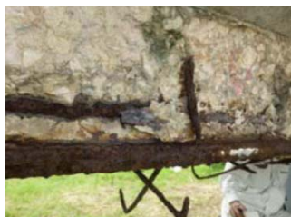
写真-6 W-3 桁の側面の劣化状況
