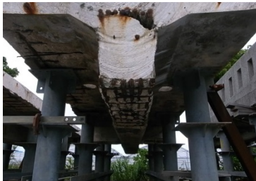
写真-3 W-4 桁の劣化状況
