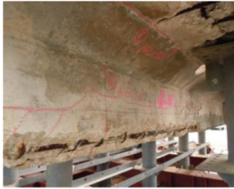
写真-2 W-1 桁の劣化状況
