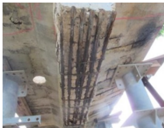
写真-4 W-3 桁の劣化状況
