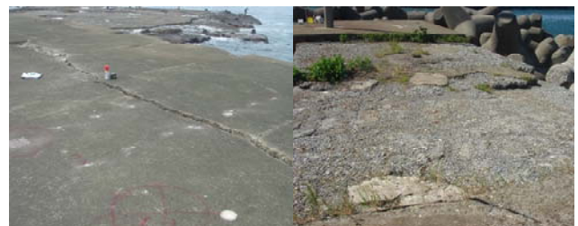
図-1 漁港施設における老朽化の状況
