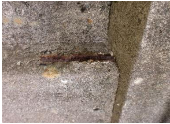
写真-2 高欄内側の鉄筋露出
