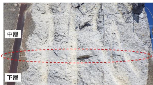
写真-5 中層-下層間のコールドジョイント
