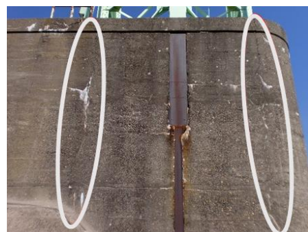
写真-6 上部トラス直下に見られたひび割れ
