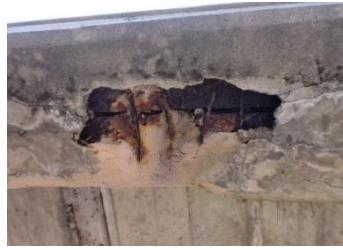
写真-3 内部鉄骨の腐食
