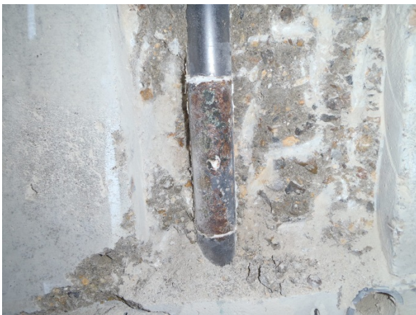
図-12 腐食試験片はつり出し
