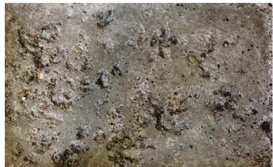
写真-1 粗骨材露出現象
