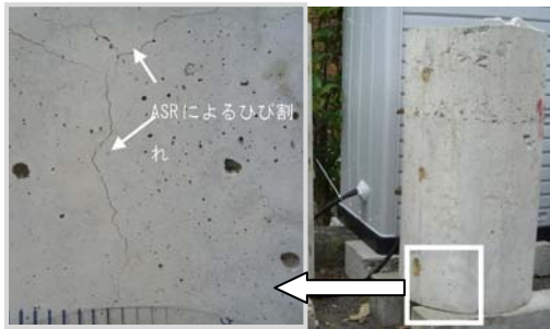
写真-2 屋外暴露した大型コンクリート供試体のひび割れ状況 (図-9の946日の観察)
