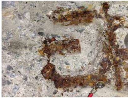
写真-1 鉄筋の腐食状態
