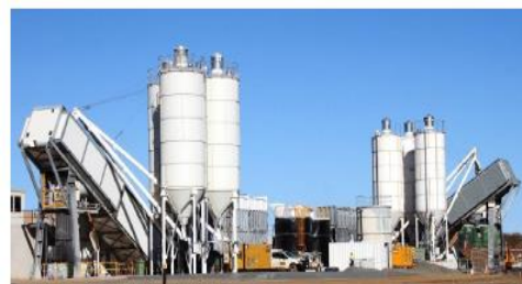
写真-5 バッチャープラント
