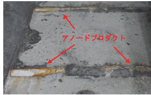
図-4 線状陽極に発生したアノードプロダクト
